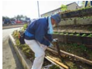
花壇と階段は老朽化。 毎回修理しています。
